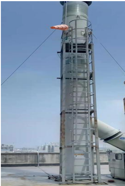
G30 车间室内换风排气筒
