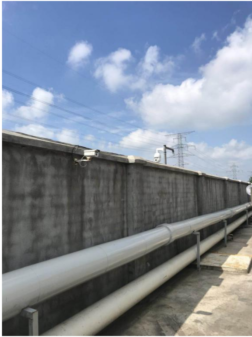
危废库外视频监控
