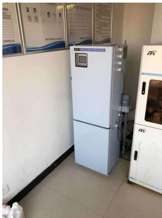
废水总排口-总磷在线
