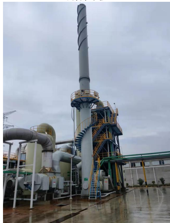
6#RTO 系统排气筒
