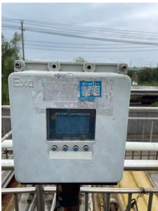
废水总排口-pH 在线
