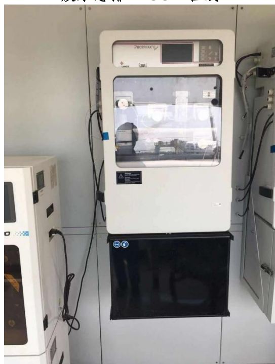
废水总排口-氨氮在线
