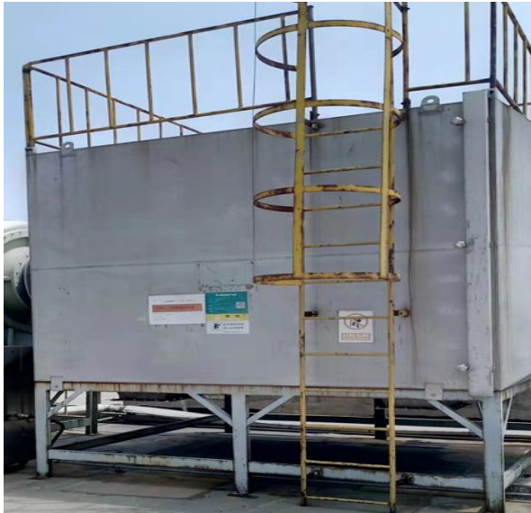
一级活性炭吸附（车间室内换风）
