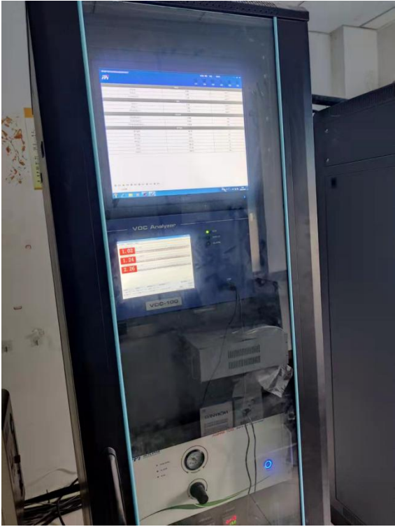
6#RTO 焚烧炉系统在线非甲烷总烃
