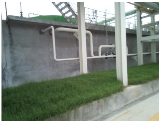
二期反硝化池
