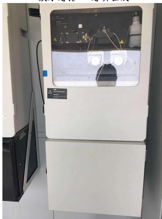
废水总排口-总氮在线
