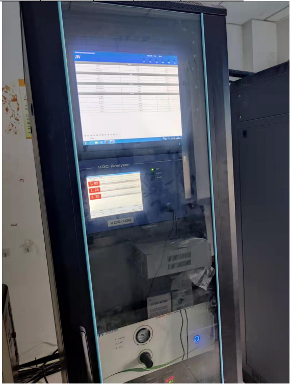
6#RTO 焚烧炉系统在线非甲烷总烃
