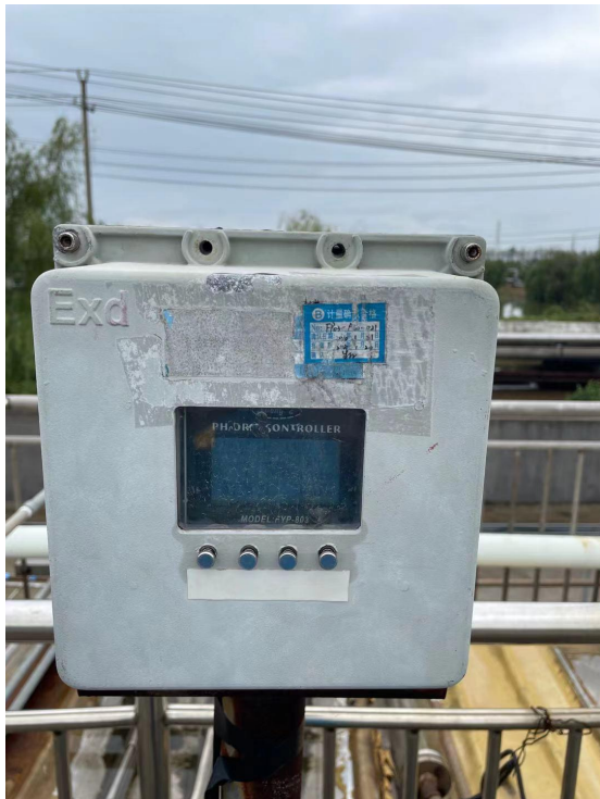
废水总排口-pH 在线
