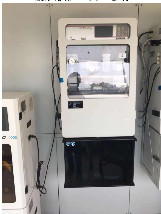
废水总排口-氨氮在线
