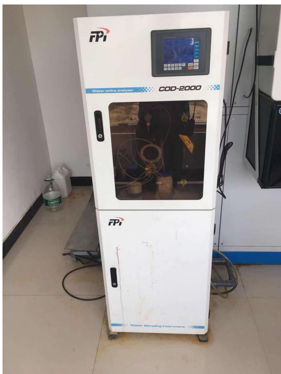
废水总排口-COD 在线
