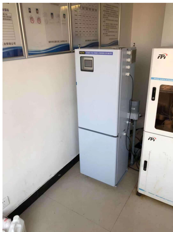
废水总排口-总磷在线
